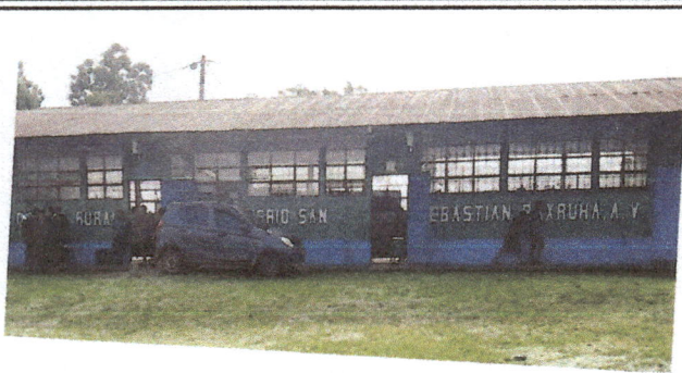
MODULO 1: CAMBIO DE LAMINAS. Se observa el deterioro y la necesidad del cambio total de las laminas, lijado y pintada de las costaneras.
